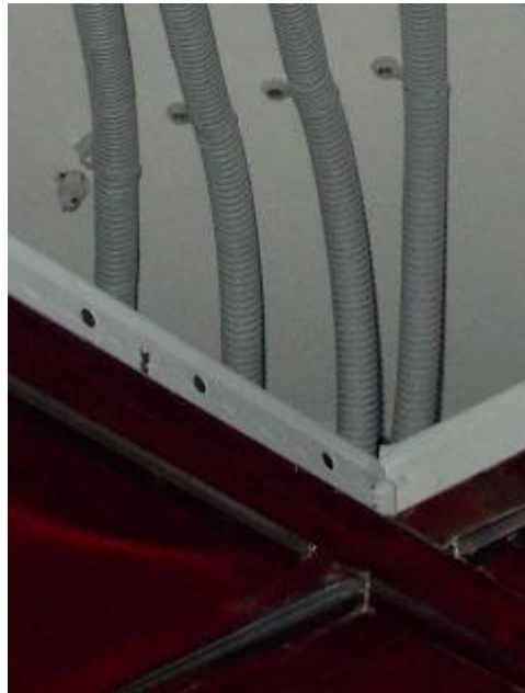
Рисунок 6.1.1 – Крепление гофрированного кабель – канала за подвесным потолком
