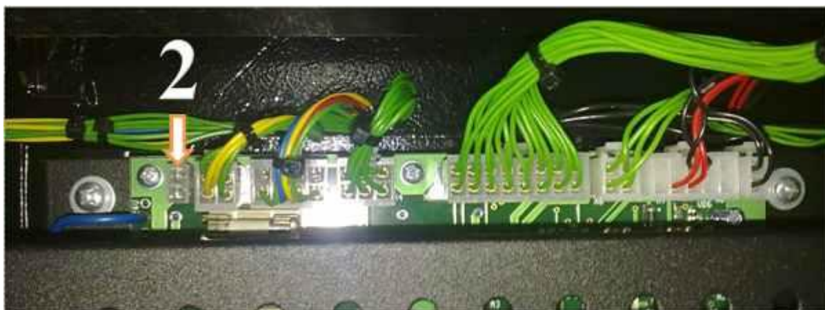
Рисунок 3.3.3 – Подключение кабеля питания (2)
