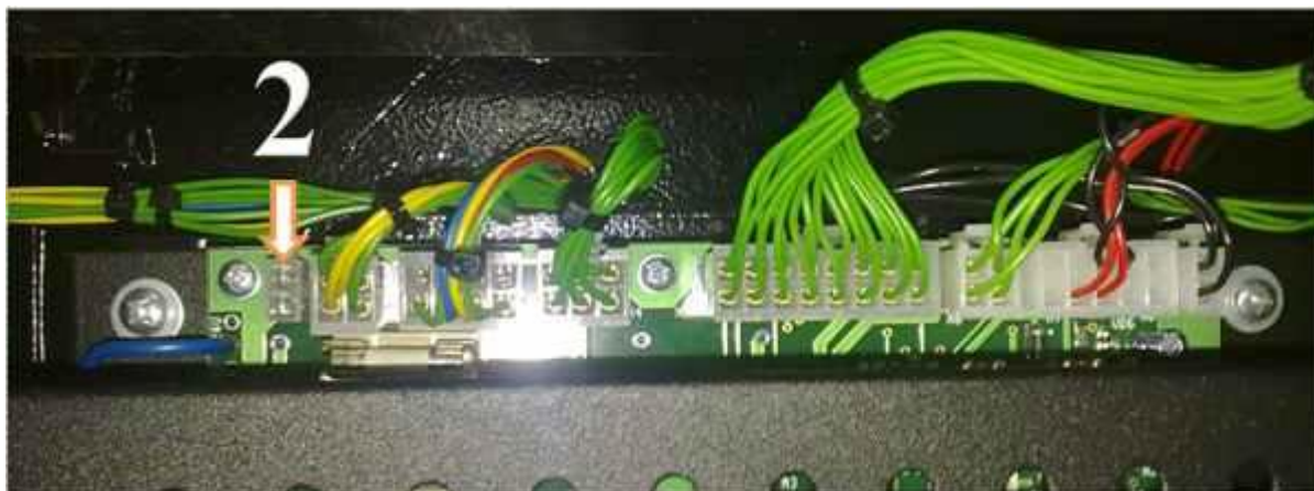
Рисунок 3.3.3 – Подключение кабеля питания (2)
